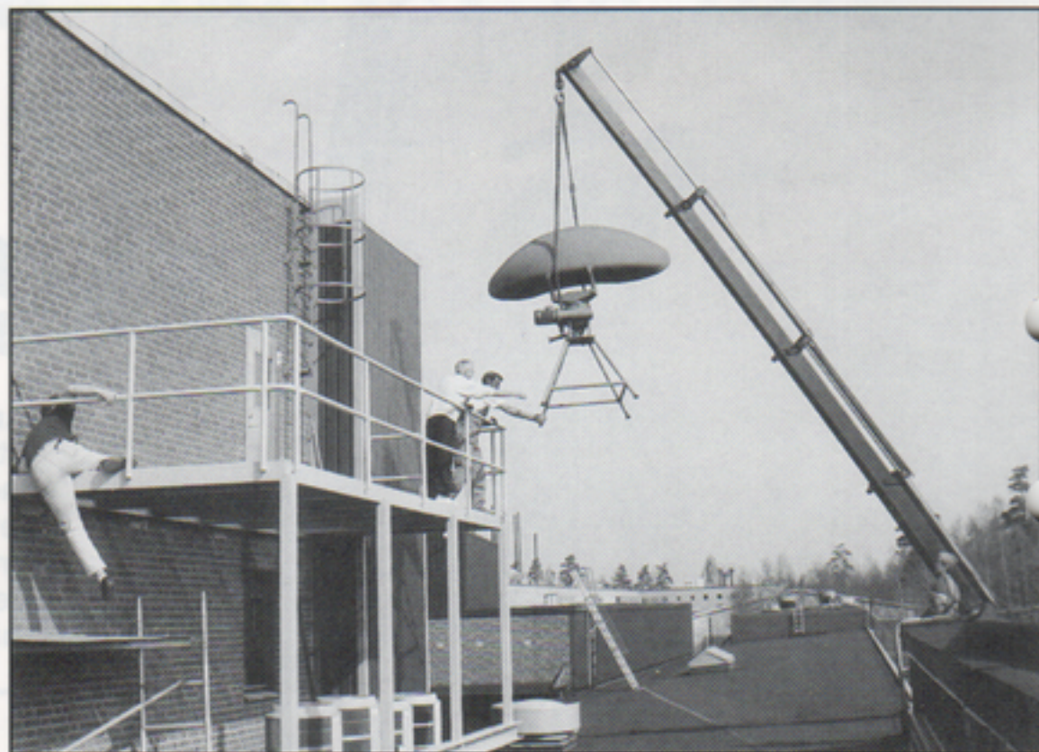
Hjälpande händer och en lyftkran får antennerna på plats på den specialbyggda balkongen på norra gaveln på byggnad 105.
