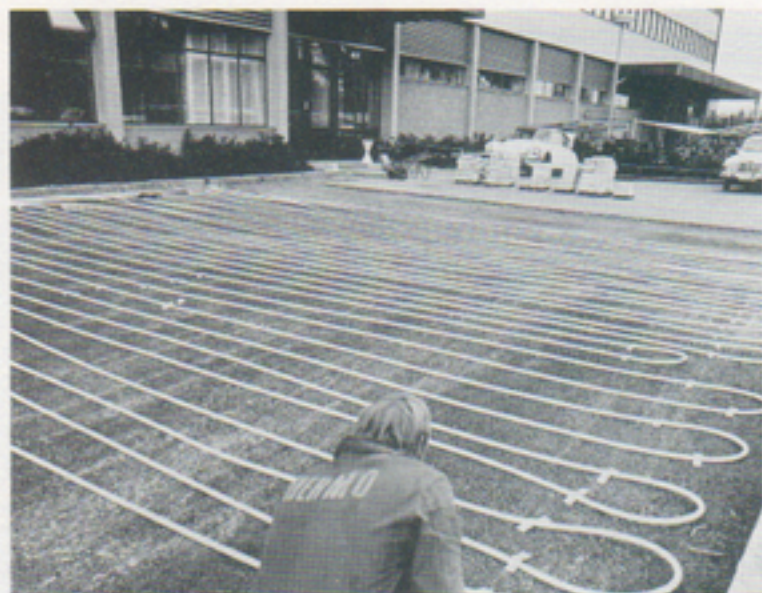
Så här ser det ut under asfalten vid nya kontorsentrén. Värmslingor skall hjälpa till att hålla snömodden borta, med en renare entré och trappa som resultat.
