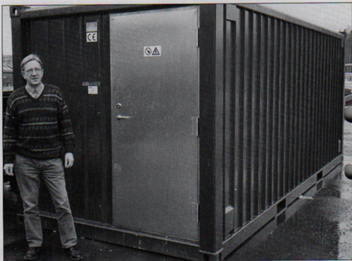
Jan Persson på Elektro är projektledare för FMV-uppdraget att förse den svenska bataljonen i Tuzla med hög eldriftsäkerhet. Ställverkscontainer är snart på väg ner till Tuzla i ett Herculesplan.
