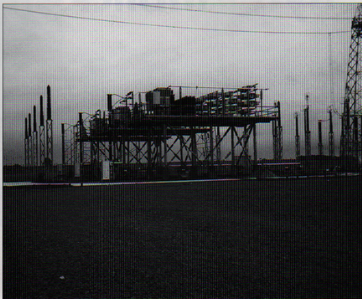
På Pampas slätter, där kraftöverföringen sker över en 150 mil lång sträcka, finns ett antal anläggningar med kondensatorer monterade på stora plattformar sex meter ovan mark. Detta var Anders arbetsplats under fyra veckor i juni där han utförde kontroller av skarvning och anslutning av optofiberkablar, som används vid kommunikation mellan kondensatoranläggning och kontrollrumsbyggnad.
