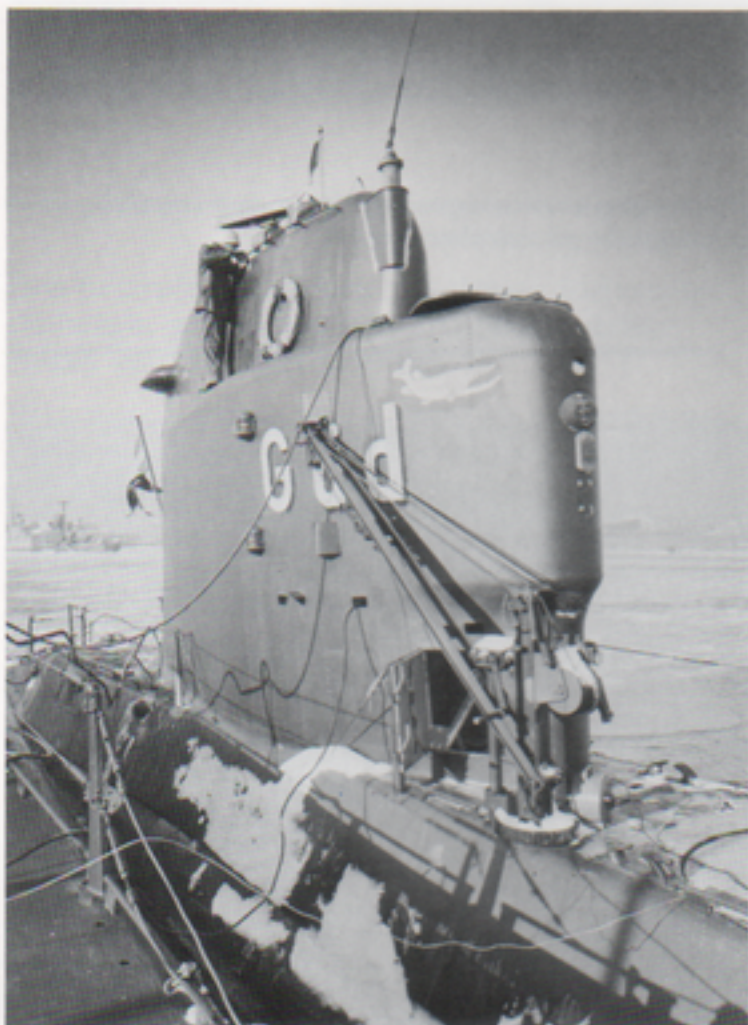
FTG utför teleunderhåll och installationer åt samtliga vapenslag. Här sker installation av antenn för navigeringsradar på ubåten Gäddan.
